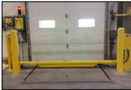
Protección contra colisiones para cortina metálica.
